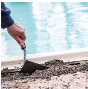
07. Relleno de la solera con cemento para la colocación de los bordes
